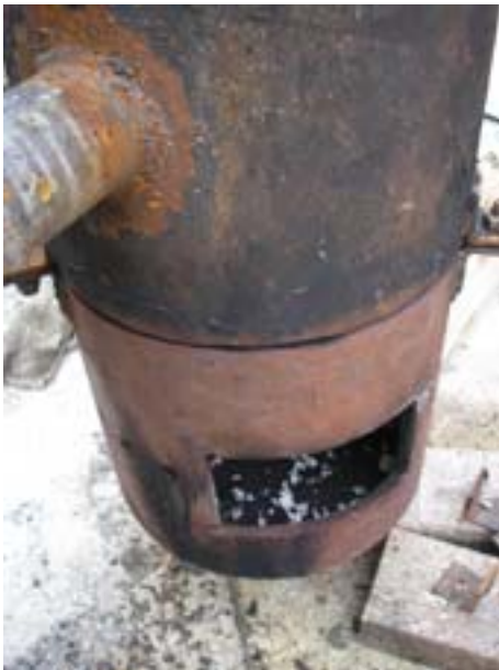
Рис 4. Горелка прикручена к котлу.
